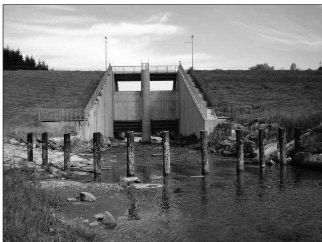
Фиг. 6. Поглед от завиряваната част към изпускателното съоръжение на РБВВ Хамершмиде на река Глат
